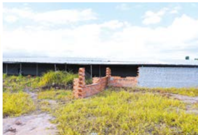
● Công trình xây dựng trái phép tại khu vực Dự án Khu Công nghiệp Ninh Xuân 1.
