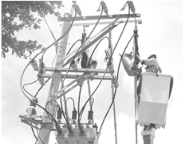
● Công nhân Công ty Điện lực Khánh Hòa kiểm tra lưới điện trước các sự kiện trọng điểm của tỉnh.
