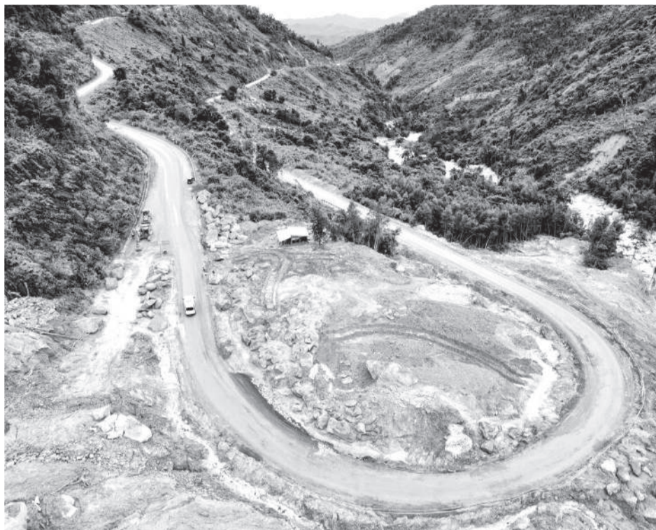
● Tuyến Quốc lộ 27C nối Nha Trang - Đà Lạt hiện nay thường xuyên bị sạt lở vào mùa mưa lũ, không đảm bảo an toàn giao thông.
