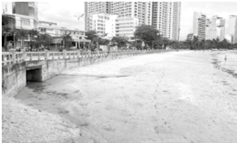
● Khu vực cửa xả Đặng Tất (phường Bắc Nha Trang) xảy ra tình trạng nước thải chảy ra biển khi có mưa lớn.
