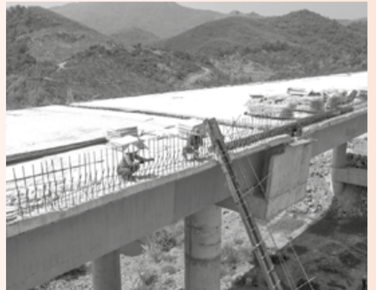
● Công nhân miệt mài thi công cầu Km30 dưới cái nắng gay gắt.
