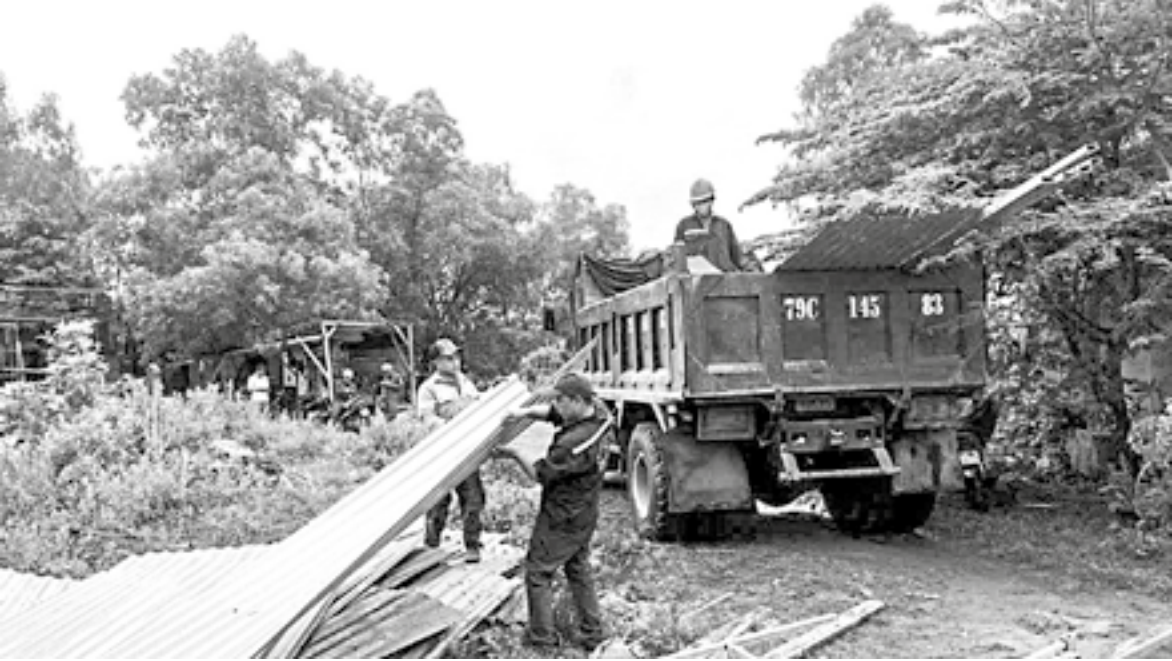
● Lực lượng chức năng phường Nam Nha Trang xử lý tháo dỡ các công trình xây dựng vi phạm.
