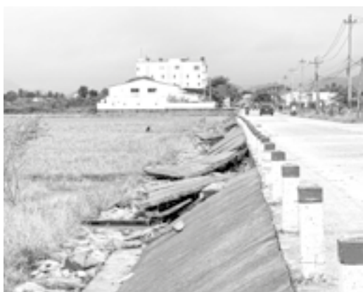
Bờ kè đường Nguyễn Lương Bằng bị sạt lở.
