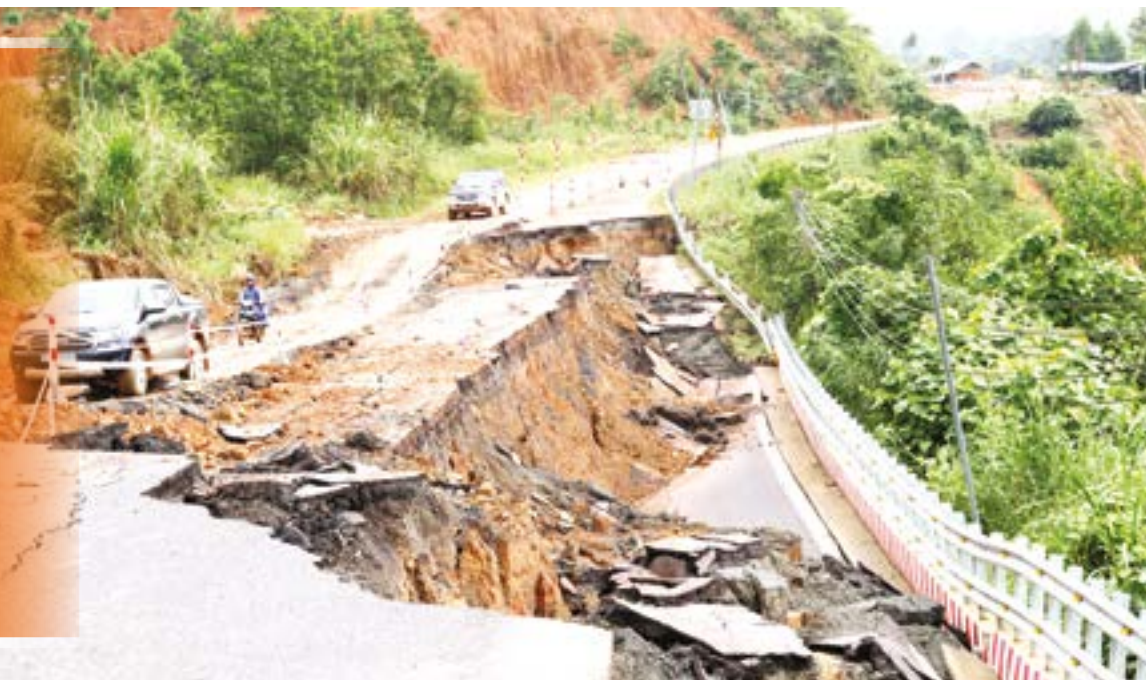
● Đèo Khánh Lê bị sạt lở, đứt gãy khiến giao thông bị tê liệt hoàn toàn nửa tháng nay.
