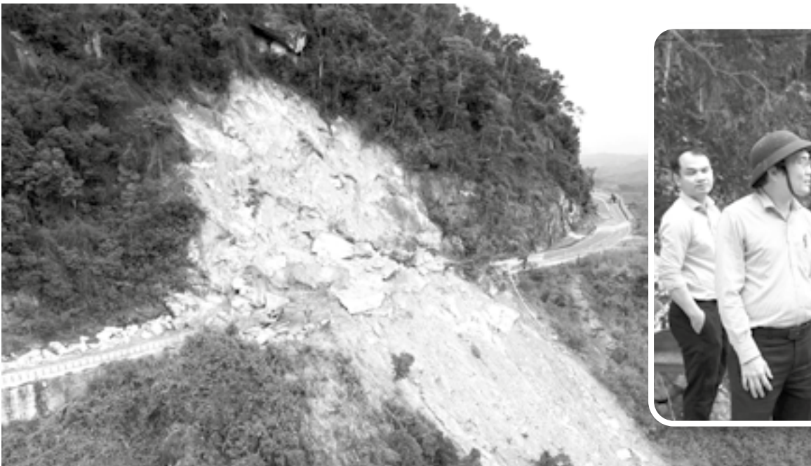
● Đèo Khánh Lê bị sạt lở nghiêm trọng khiến giao thông tê liệt hoàn toàn.
