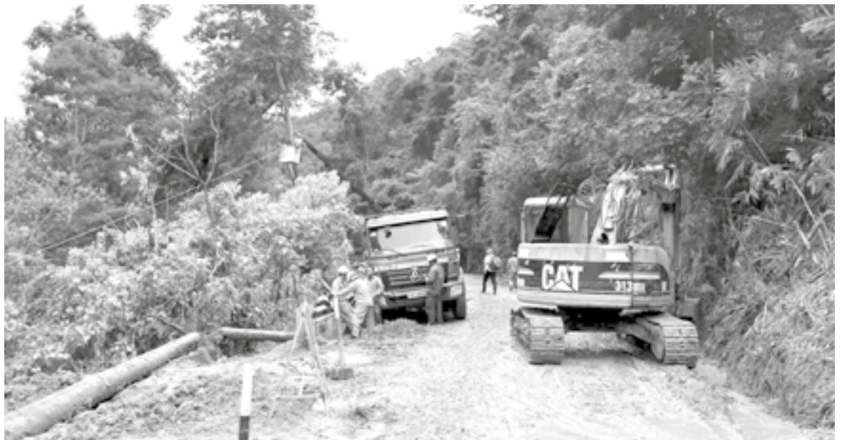
● Khắc phục sạt lở trên tuyến Tỉnh lộ 707.
