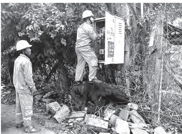
● Thực hiện đóng điện tại vùng ngập lụt.
