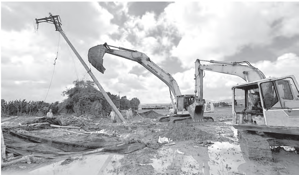
● Dựng lại cột điện ngã đổ ở khu vực Diên Khánh.
