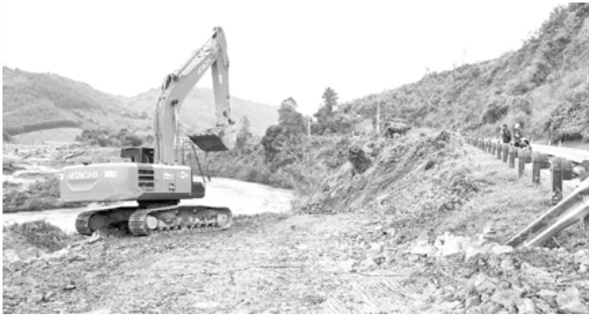
● Lực lượng chức năng nỗ lực khắc phục điểm sạt lở trên Quốc lộ 27C đoạn qua thôn Đá Trắng.
