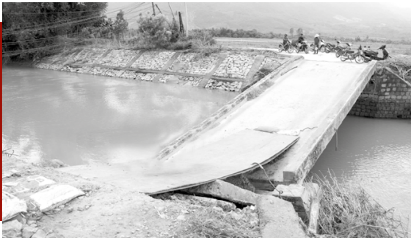
● Cầu suối Bà Tứ (xã Nam Ninh Hòa) bị sập một bên gây nguy hiểm cho người dân đi lại.
