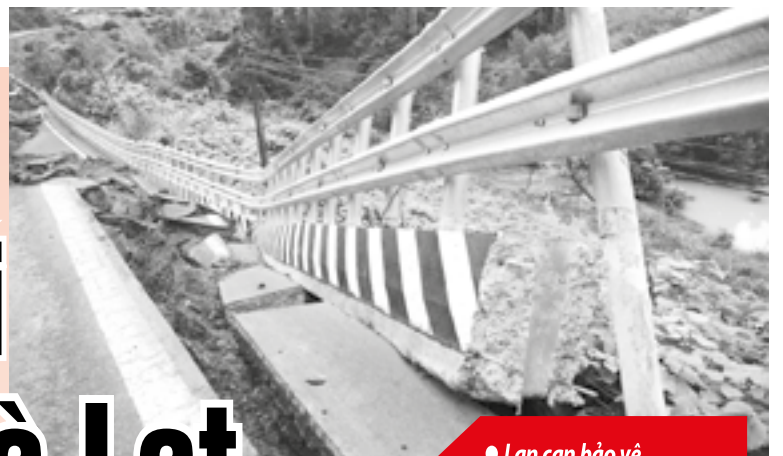
● Lan can bảo vệ trên đèo Khánh Lê bị gãy.
