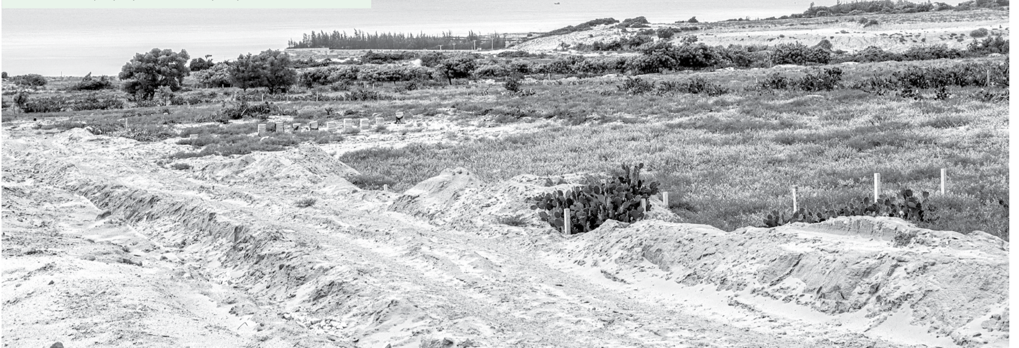
● Vị trí xây dựng Nhà máy điện hạt nhân Ninh Thuận 1 (xã Phước Dinh).
