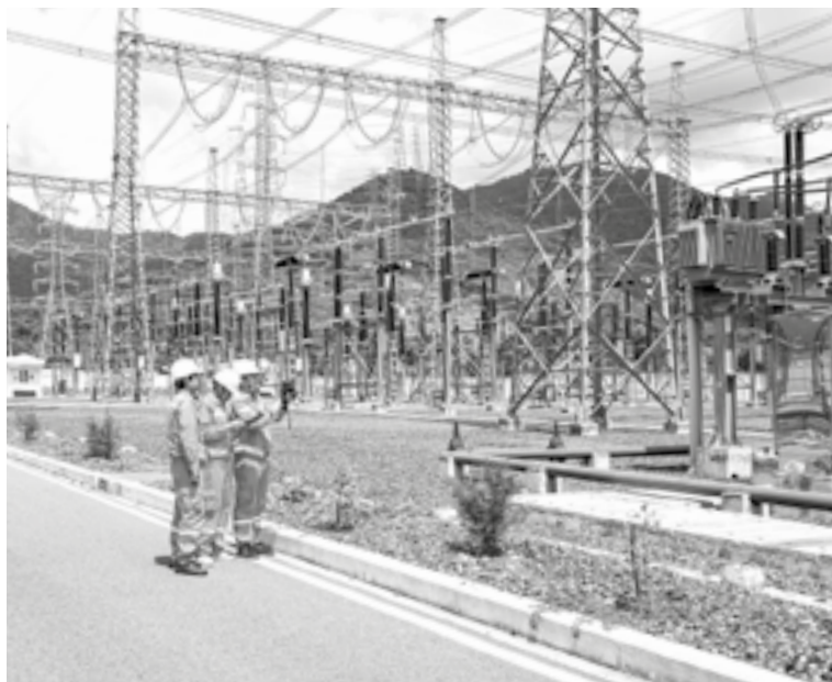
● Kiểm tra hằng ngày tại Trạm biến áp 500kV Vân Phong.
