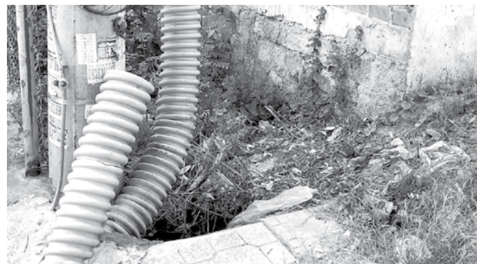
● Vị trí mương thoát nước ngập rác.
