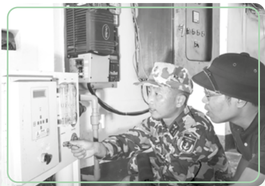
● Khu vực vận hành máy lọc nước biển thành nước ngọt trên đảo Len Đao.
