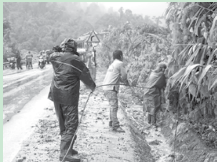
● Sự cố làm ảnh hưởng tới hệ thống đường dây thông tin. Nhân viên phải mở đường xuyên rừng trên đèo để tìm đường đấu nối dây, tránh ảnh hưởng toàn hệ thống.
