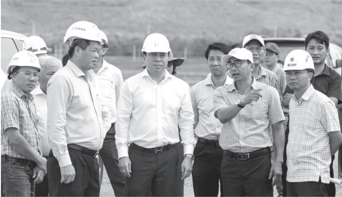
● Đồng chí Nguyễn Khắc Toàn kiểm tra vướng mắc tại công trình đường bộ cao tốc Vân Phong - Nha Trang.
