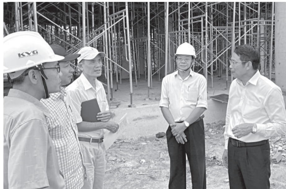
● Đồng chí Đinh Văn Thiệu kiểm tra công trình dự án Trung tâm Y tế huyện Vạn Ninh.
