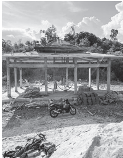
● Công trình xây dựng trái phép tại khu vực đỉnh đèo Rù Rì thuộc Tổ 24 Tây Bắc (phường Vĩnh Hải).
