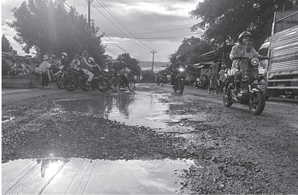
● Tỉnh lộ 9 đoạn qua xã Sơn Bình bị xuống cấp.
