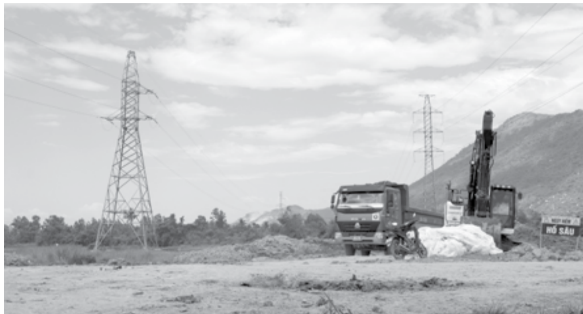
● Cao tốc Vân Phong - Nha Trang, đoạn qua huyện Vạn Ninh có 44 điểm giao cắt với lưới điện cao thế.
